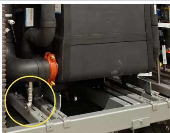
Opróżnianie zaworu obok płytowego wymiennika ciepła
